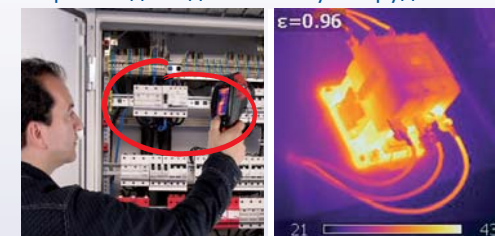
Заблаговременное диагностическое обследование электрических цепей и приборов позволяет избежать аварий.
